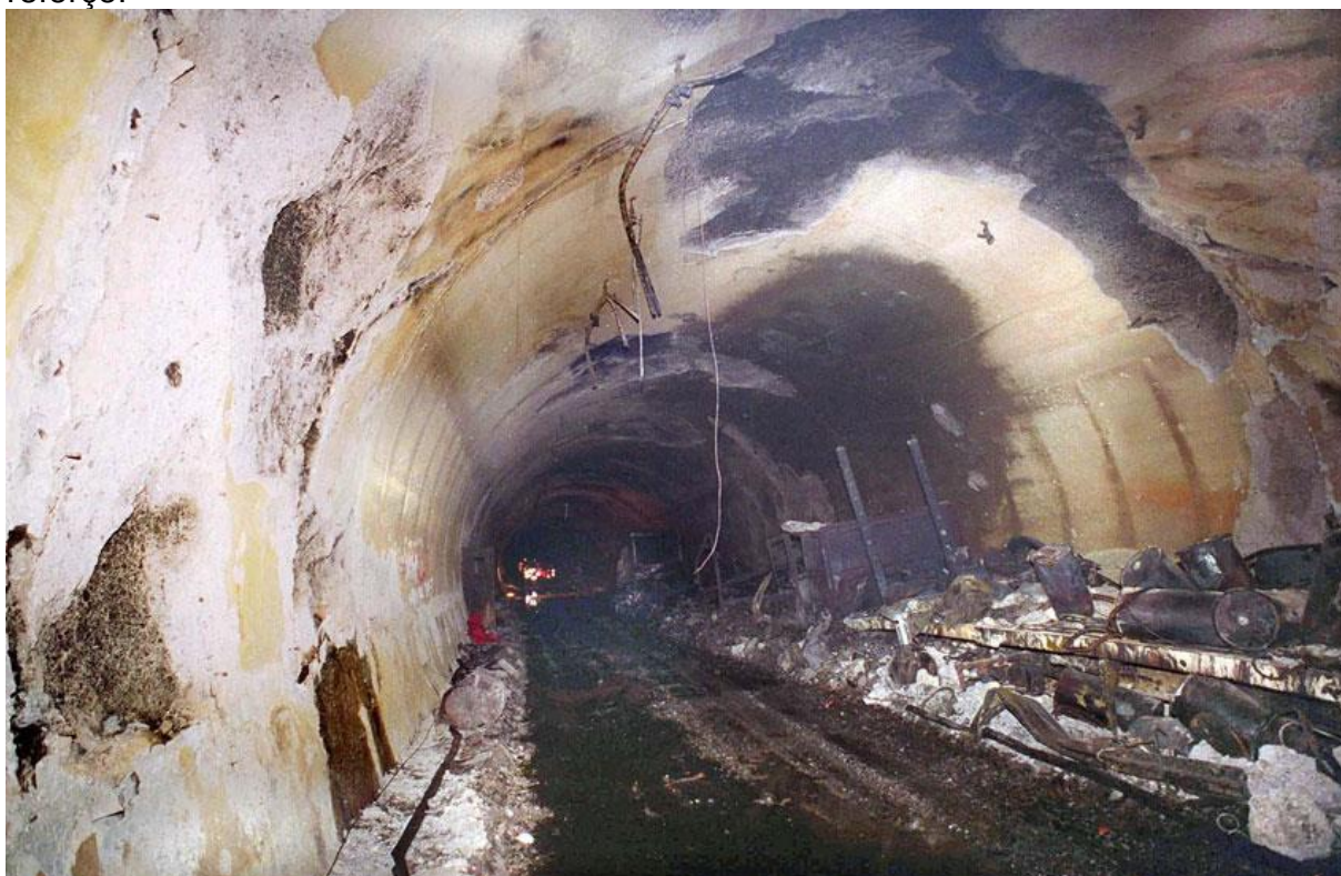
Figura 5: Situação interna do Túnel Mont Blanc pós ocorrência do incêndio – destaque para a ocorrência de spalling de forma profunda (Fonte: https://www.tunneltalk.com/Fire-safety-Jun01-Mont-Blanc-highway-fire-reconstruction.php , acessado em 03/12/2018)
