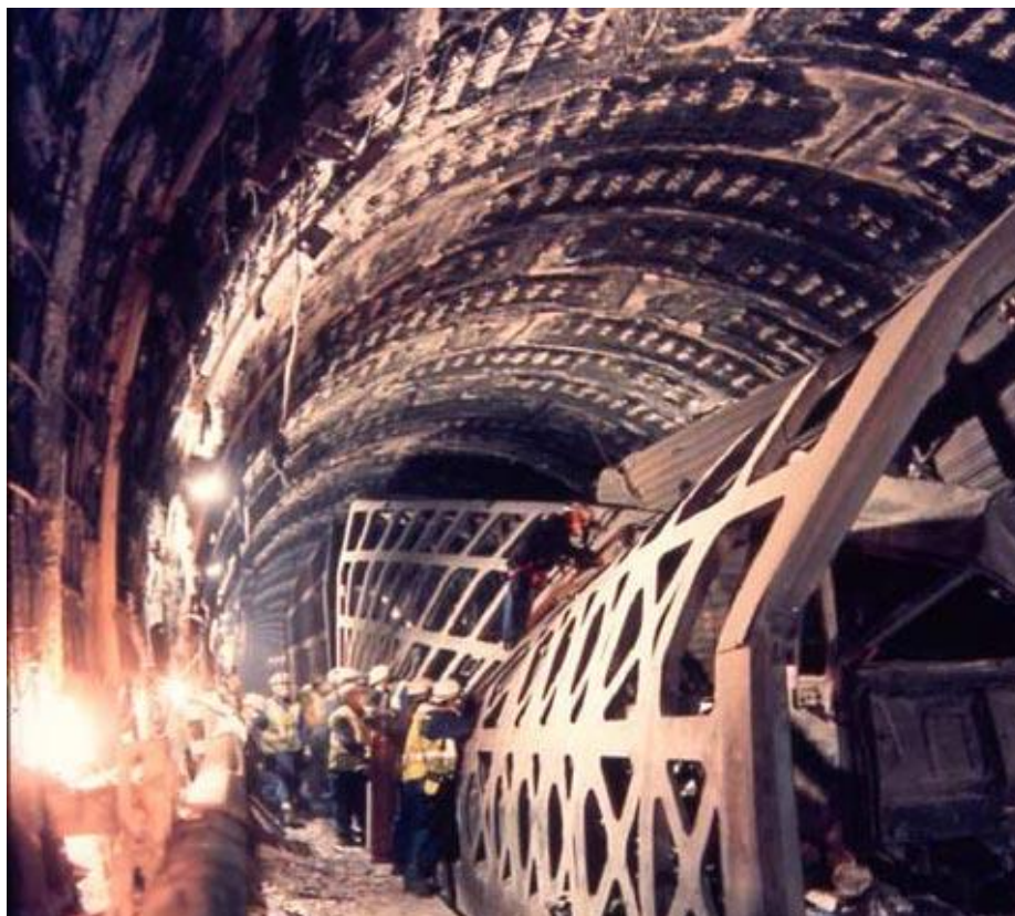
Figura 4 - Danos devido ao spalling no revestimento de concreto no incêndio de 2008 no Eurotúnel (fonte: https://www.tunneltalk.com/TunnelTech-May12-Concrete-fire-spalling.php , acessado dia 03/12/2018)
