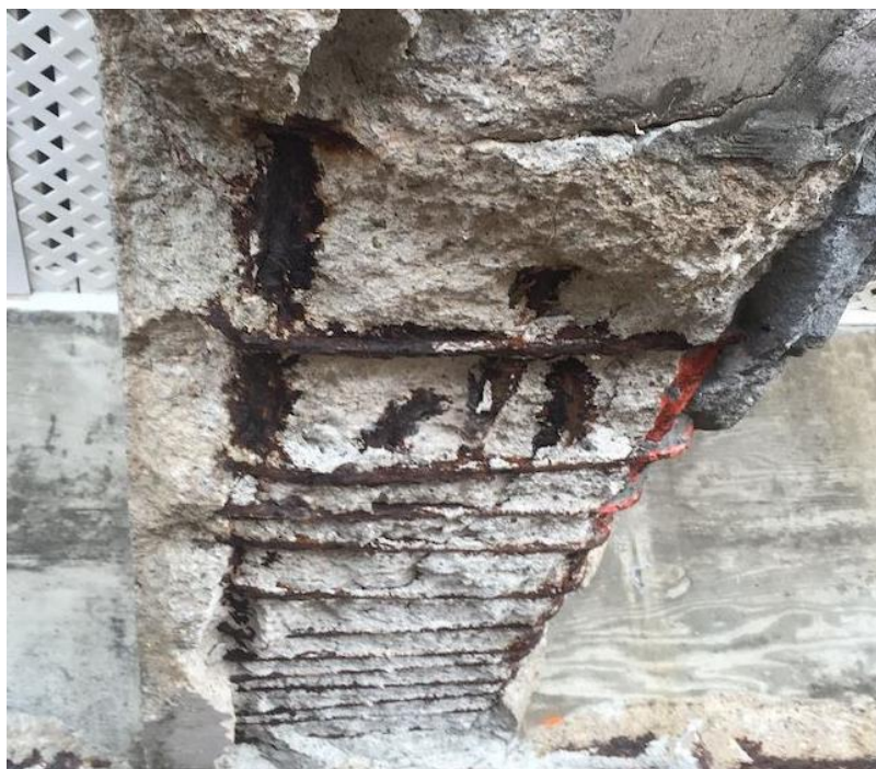
Figura 3 - Armadura de viga exposta devido ao spalling (fonte: https://www.alphastructural.com/project-gallery/spalling-concrete/ , acessado em 03/12/2018)
